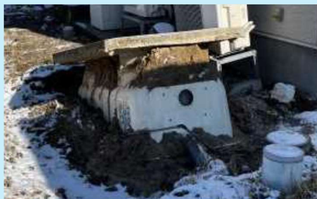
地震により浮き上がった浄化槽
